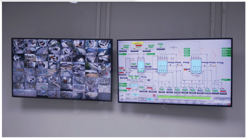
ภาพที่ ๕ การควบคุมการทำงานด้วยระบบ SCADA
