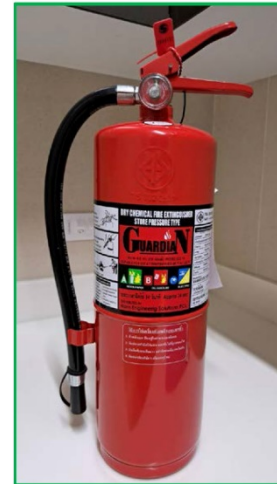
ถังดับเพลิง ชนิดผงเคมีแห้ง (Dry Chemical)
