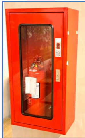
ตู้เก็บถังดับเพลิง
