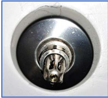
สปริงเกอร์ดับเพลิง
