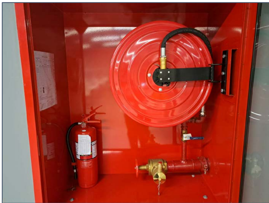
จุดที่ตั้งถังดับเพลิง หอสมุดรัฐสภา ชั้น 9 (จุดที่ 9C-02)
