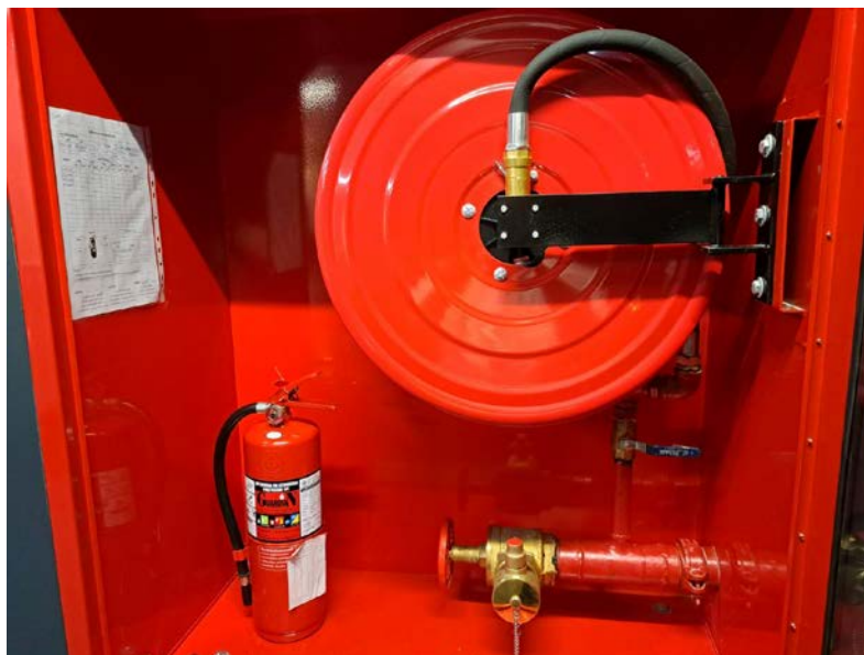
จุดที่ตั้งถังดับเพลิง หอสมุดรัฐสภา ชั้น 10 (จุดที่ 10C-05)
