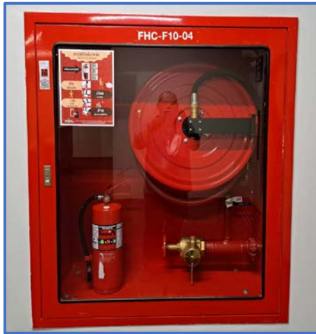
สายฉีดน้ำดับเพลิงและตู้เก็บสายฉีด
