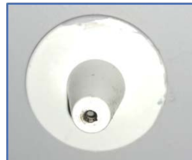
อุปกรณ์ตรวจจับควัน
