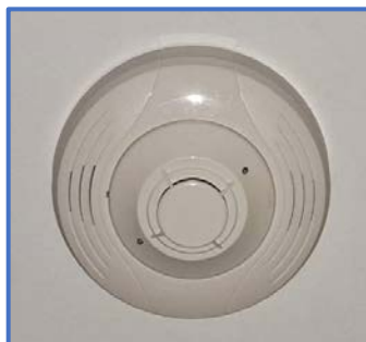
อุปกรณ์ตรวจจับควัน
